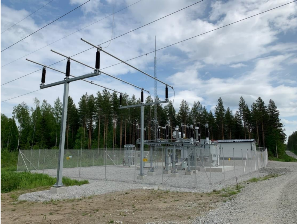
Kuva 3-6. Esimerkkikuva sähköasemasta (Lähde: ABO Wind Oy).
