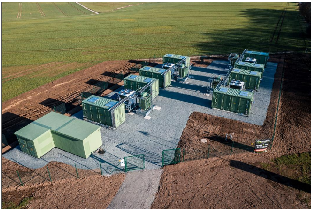
Kuva 3-7. Esimerkki sähköasemaan yhteyteen sijoitettavasta akkujärjestelmästä (Lähde: ABO Wind Oy).
